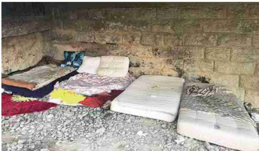
Des matelas posés au pied d'un pilier du pont Butin. DR
